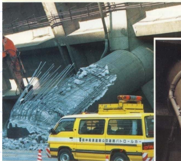
阪神大震災でみられた橋梁の破壊例
