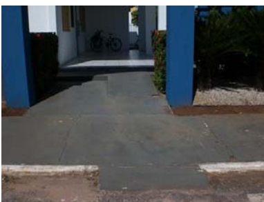
Figura 08 - Ausência – rebaixamento Fonte: Carignani (2008)
