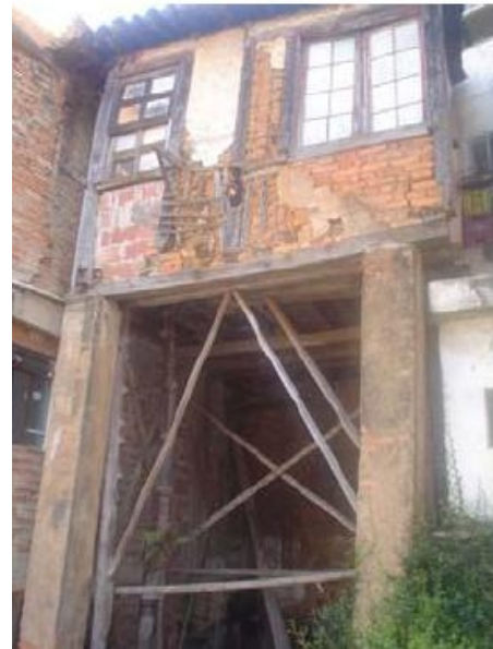
Figura 6: Exemplo de deterioração dos edifícios
