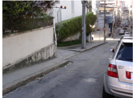
Figura 4. Calçada N1. Degradada, sem o menor sinal de manutenção. Fonte: Acervo próprio
