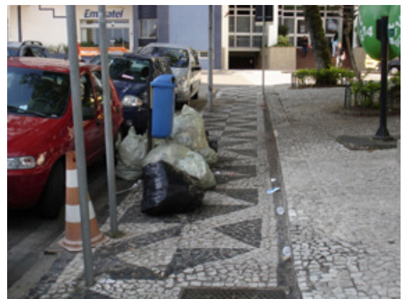
Figura 8. Calçada K4. Sacolas de lixo acumuladas no passeio geram mal cheiro e obstruem a passagem. Fonte: Acervo próprio
