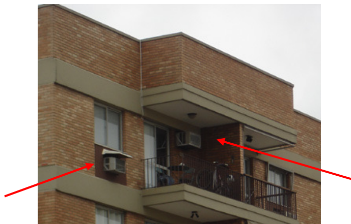
Fig.4: aparelho de ar condicionado exposto na fachada e protegido pela varanda / Fonte: acervo próprio, 2007
