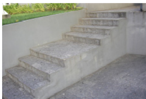
Foto 4. Escada fora dos padrões
