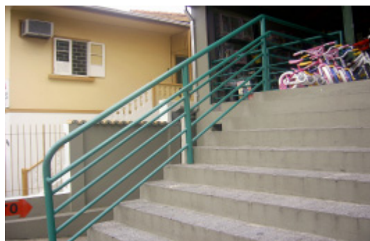
Foto 3. Escada adaptada corretamente as normas.
