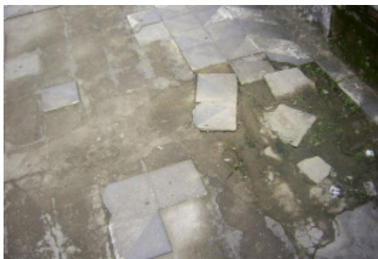
Foto 9. Piso das calçadas danificadas
