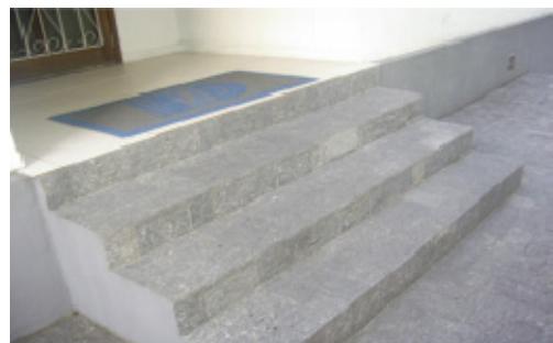
Foto 2. Escada sem corrimão
