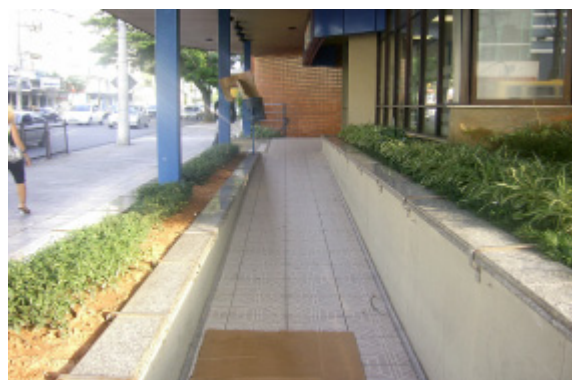
Foto 6. Rampa sem o guarda-corpo.
