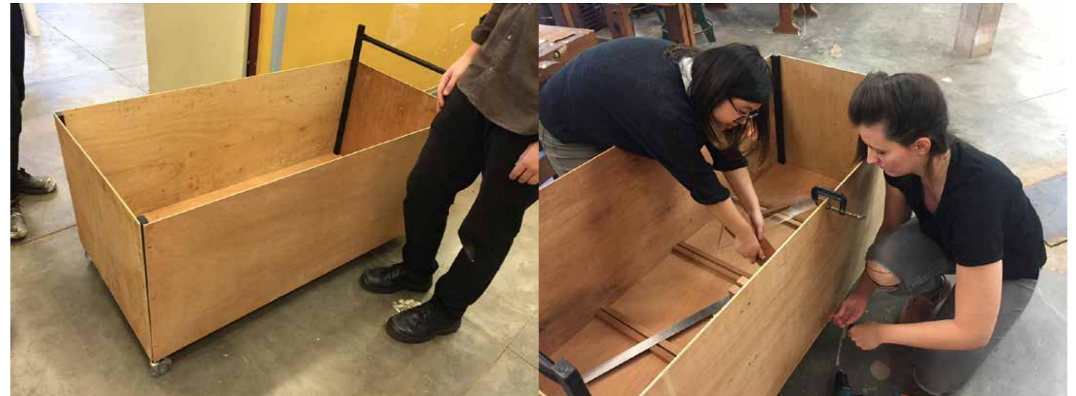
Com o fechamento externo da estrutura realizado, passou para execução das divisórias internas, feita com ripas de madeira.
