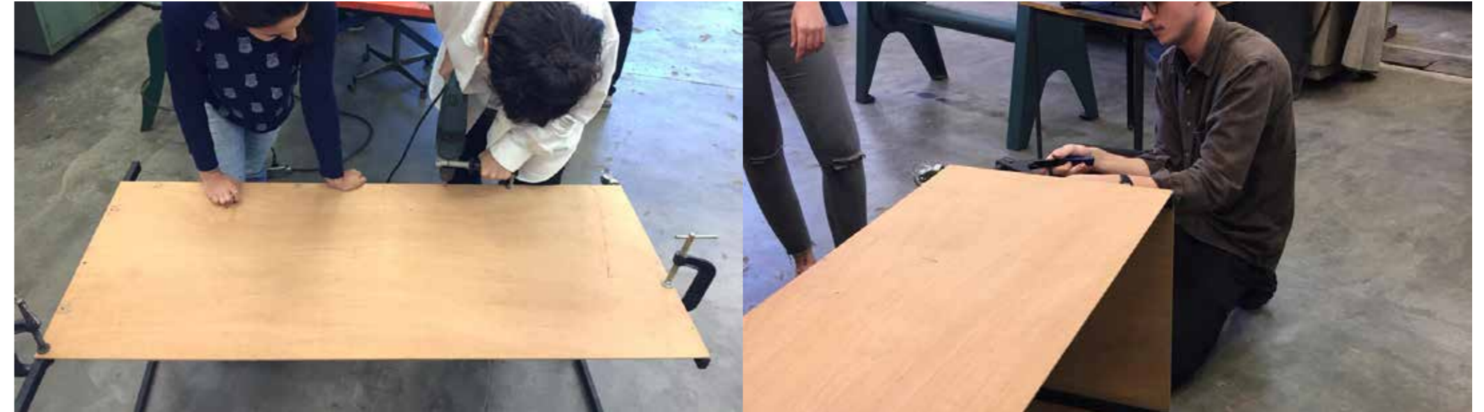
O processo de perfuração foi realizado com o auxílio de uma furadeira, e o processo de fixação das placas na estrutura foi realizado com rebites.
